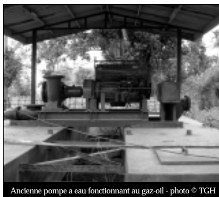
Ancienne pompe à eau fonctionnant au gaz-oil - photo © TGH
